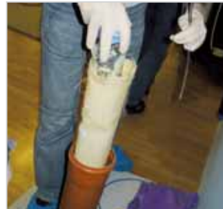
Mit diesem Packer als Einsatzmedium wird das Harz an die Schadstelle im Kanal gezogen oder geschoben.
